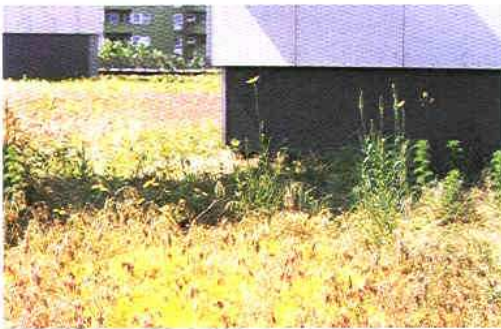
■ 9 – Zweifelhafter Wurzelschutz mit mehrlagigen PE-Folien ...
