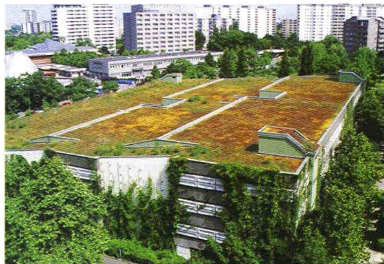
■ 8 – Mit 7000 m 2 älteste Großdachsanierung mit pflegefreier Begrünung im sechzehnten Jahr
